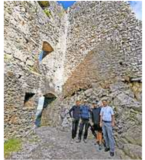
v. l. Bernhard Bischof, Hubert Mathis, Erik Winkler (alle Grabher/Hefel) und Raimund Rhomberg vor der sanierten Palas-Wand.
