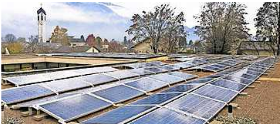
Auf dem Dach der Volksschule Herrenried wurde bereits 2016 eine Photovoltaik-Anlage in Betrieb genommen.
